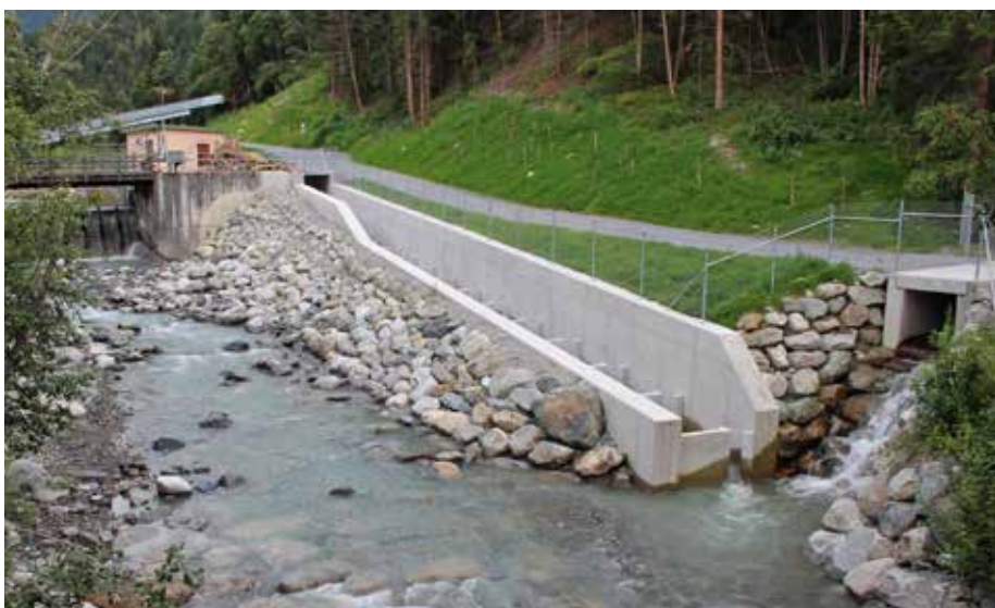
Beim Kleinwasserkraftwerk in Wennis sorgt eine Fischaufstiegshilfe für die Durchgängigkeit und Fischpassierbarkeit des Gewässers.
