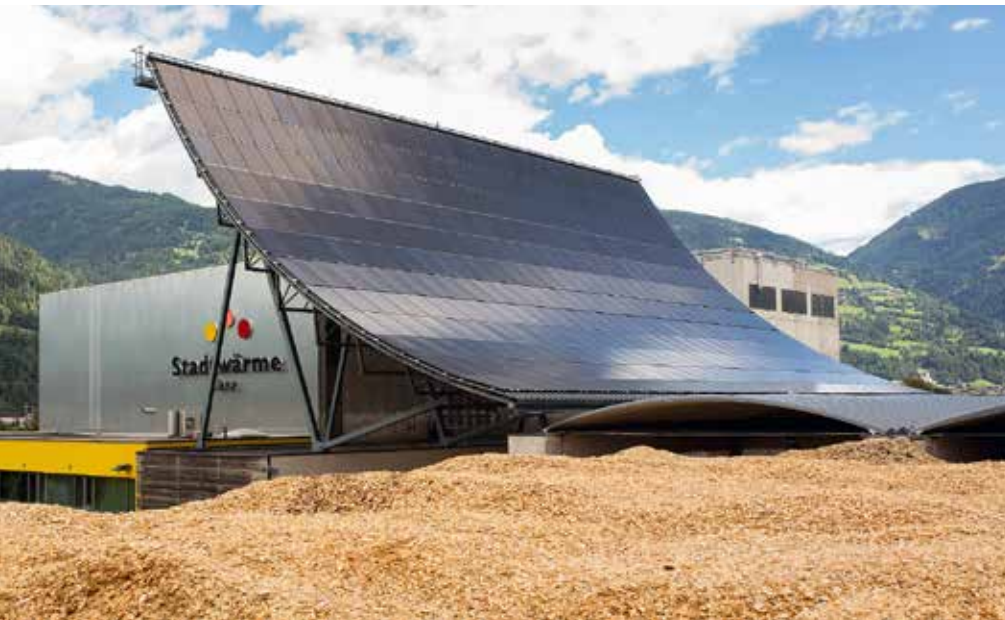
Lienz ist mit 2.000 Sonnenstunden die sonnigste Stadt Österreichs. Bei der Stadtwärme Lienz macht man sich das mit einer Photovoltaik-Anlage zunutze.
